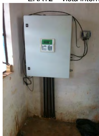
ERAT2 – Telemetria do macromedidor instalada na casa de bombas da ERAT II
