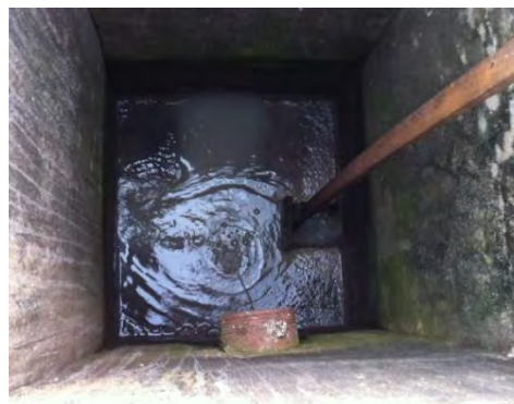
Caixa de areia e by-pass para o rio Rib. Claro
