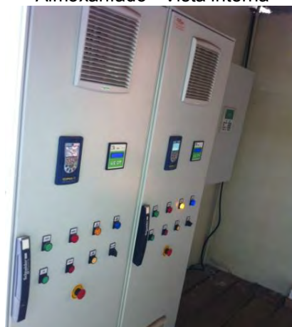
Quadros de comando
