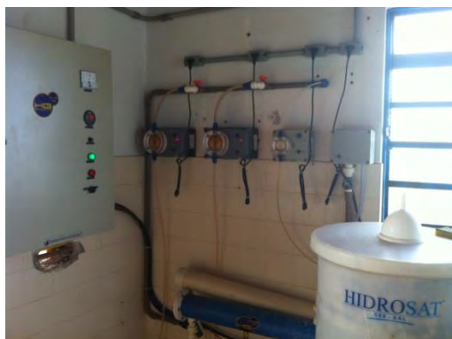
Gerador de cloro Hidrogeron, dosadoras e tanque de solução do sal (cloreto de sódio)
