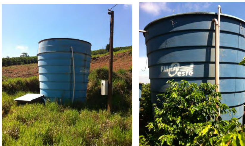
Figura 63 – Fotos (Reservatórios de 25m 3 e 20m 3 de Santa Eumância) FONTE: UNILIVRE, 2.013.
