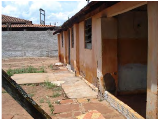
Residência que sofre alagamento
