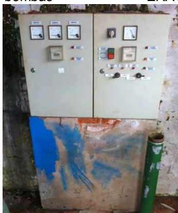
ERAT1 – Quadro de comando
