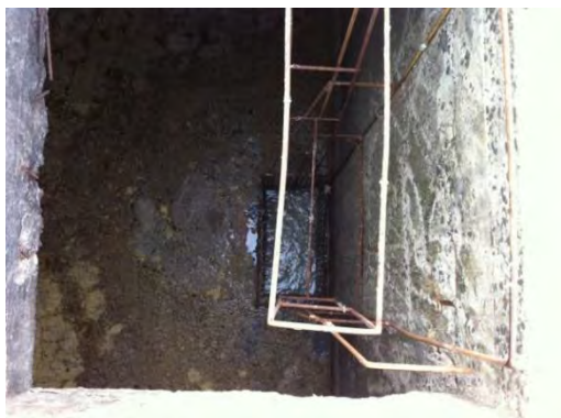
Gradeamento na entrada do poço de sucção
