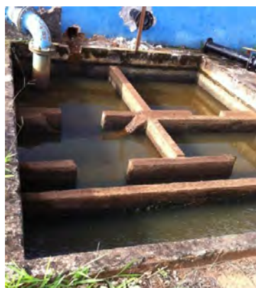
Sedimentação, poços de sucção e ao fundo a espera da nova tubulação de sucção
