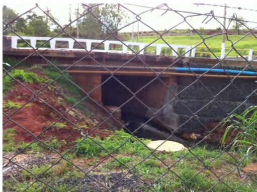
Saída da elevatória seguida pela travessia na ponte, na entrada da cidade
