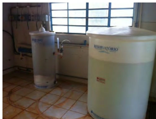
Reservatório de 1.000L de Hipoclorito de sódio
