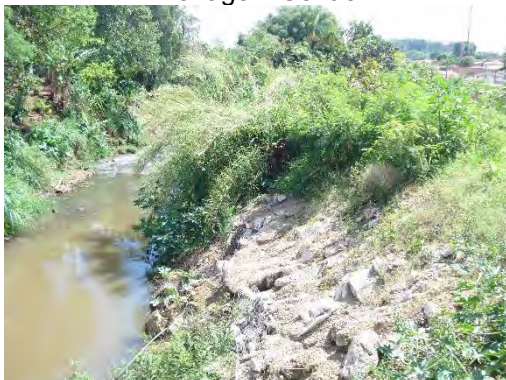
Descarga águas pluviais secundários Ribeirão Claro
