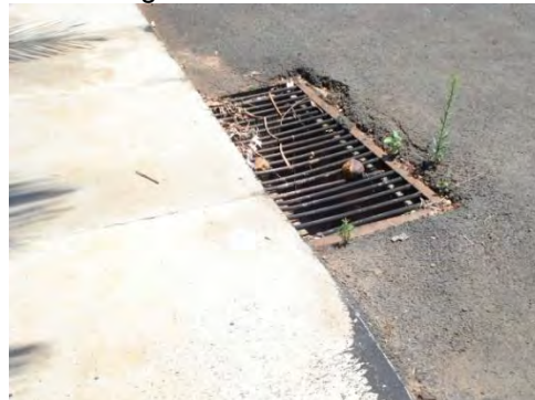
Boca de Lobo
