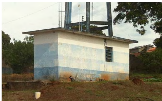
ERAT2 – Vista externa da casa de bombas
