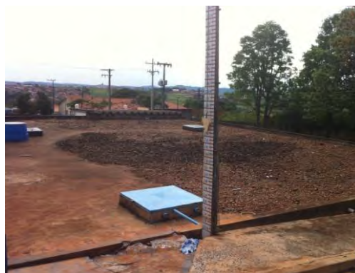
Régua – medida do nível do reservatório
