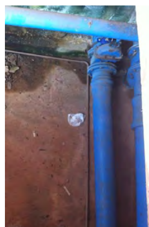
Tubulação de saída do reservatório de 1.200 m 3
