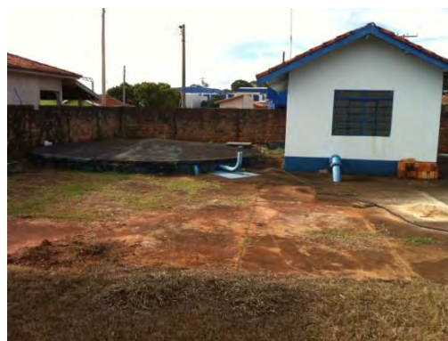
Casa de bombas e poço de sucção
