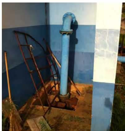
Saída da tubulação de recalque Figura 39 - Fotos (Elevatória de água bruta da Captação Superficial) FONTE: UNILIVRE, 2.013
