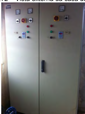
ERAT2 – Quadro de comando
