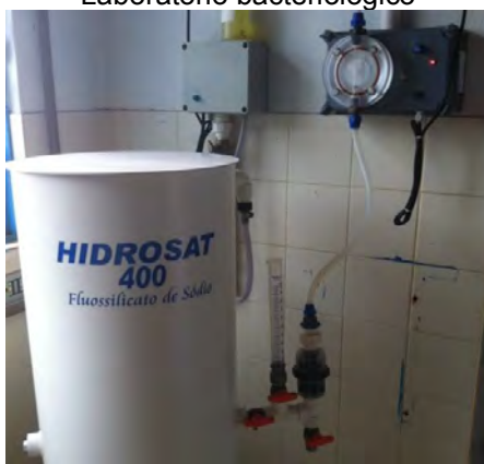
Saturador de fluor Hidrogeron e dosadora
