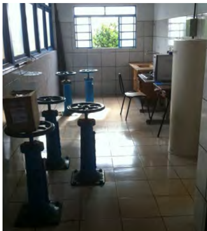
Registros para a lavagem dos Filtros
