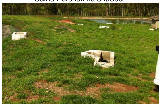
Caixas distribuidoras de esgoto
