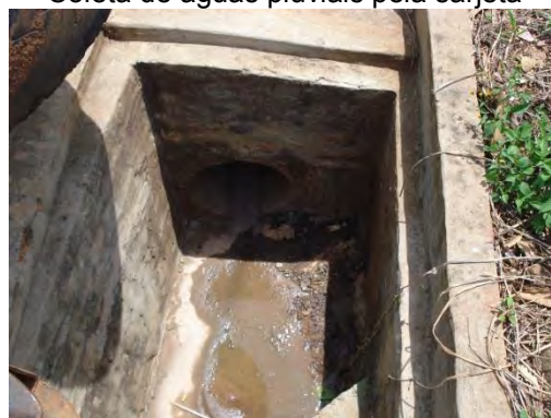
Caixa de coleta – Águas Pluviais
