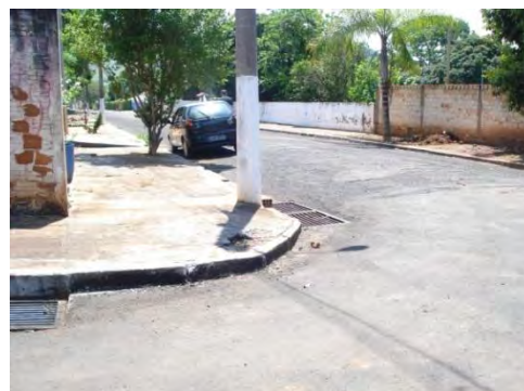
Microdrenagem urbana – Distrito Cachoeira
