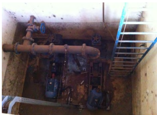
Conjuntos moto-bomba (uma delas estragada)
