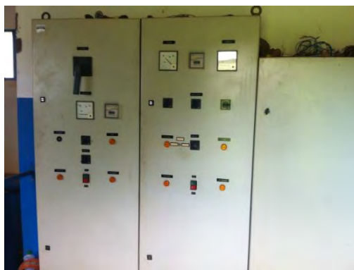
Quadros de comando
