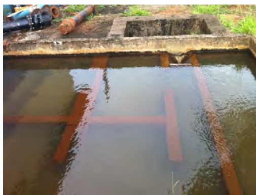
Extravasamento, retornando a água bruta para o Ribeirão Antunes
