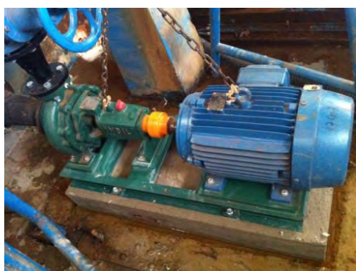
Detalhe do conjunto moto-bomba novo
