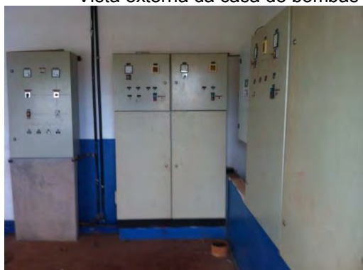
Quadros de comando
