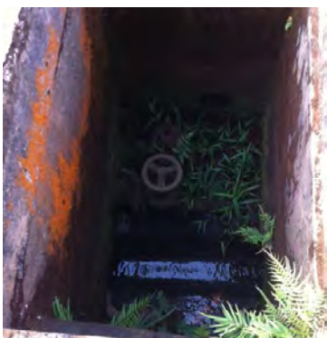
Tubulação de chegada e by-pass de retorno para o Ribeirão Antunes
