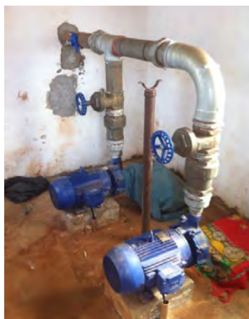
Estação elevatória para reservatório elevado
