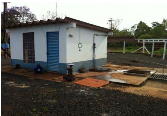
Poço de areia e de sucção. Casa de bombas
