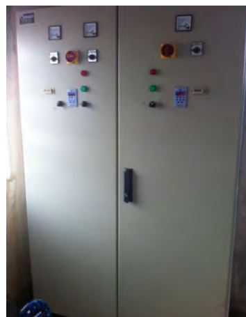
Quadro de comando da elevatória para o reservatório elevado
