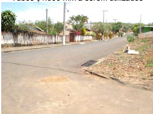
Microdrenagem urbana – Distrito Cachoeira
