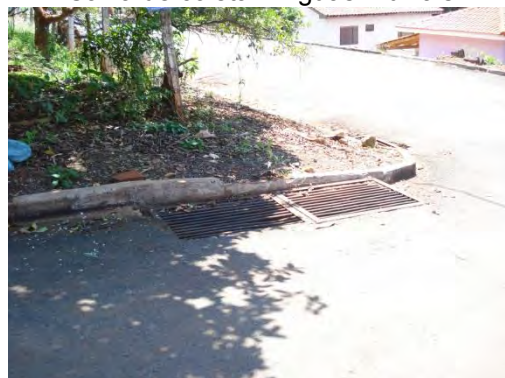
Microdrenagem urbana – Distrito Cachoeira
