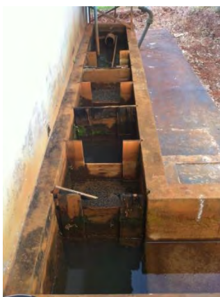
Entrada da adutora de água bruta da captação superficial e chicanas verticais
