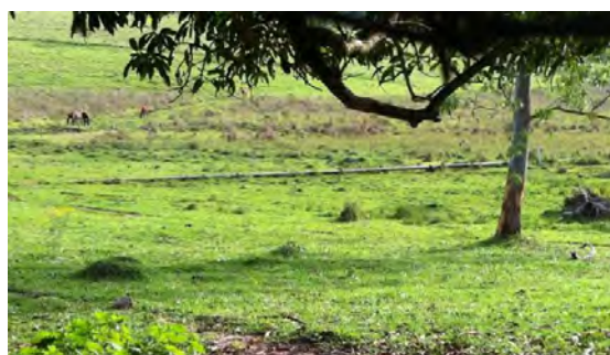
Tubulação aparente saindo na EEAB
