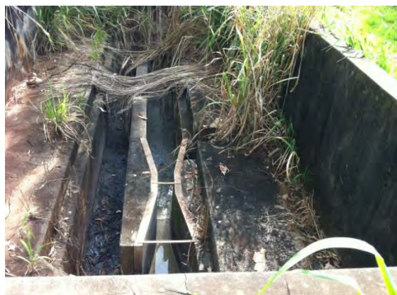
Calha Parshall na entrada
