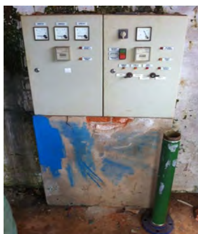
Quadro de comando da elevatória do Reservatório de 1.200 m 3
