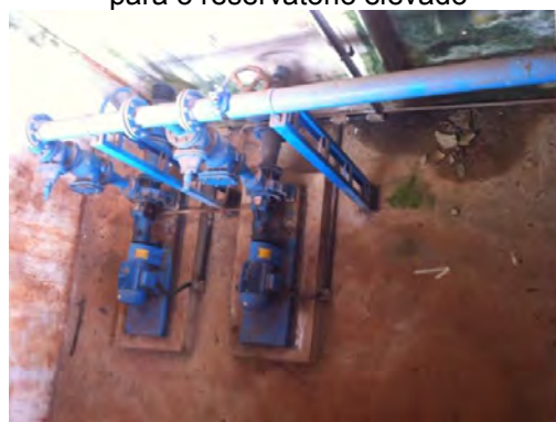
Estação elevatória do reservatório de 1.200 m 3
